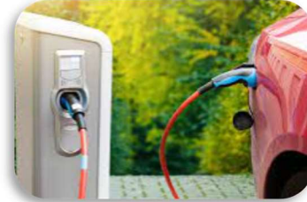
تأمین برق ورودی ایستگاه شارژ
